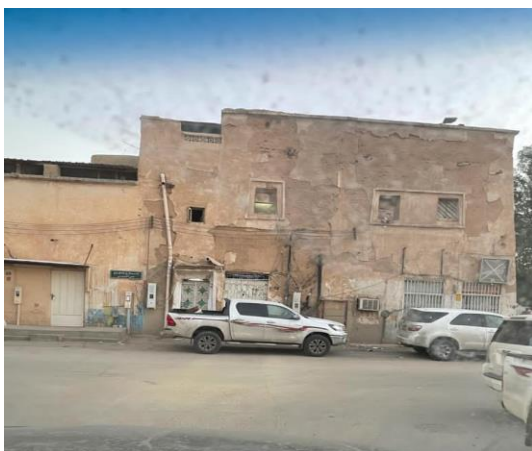
الشكل رقم (7) المباني التي بحاجة إلى ترميم المصدر: المسح الميداني
